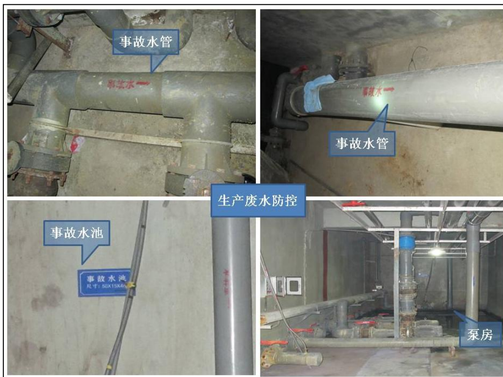
图 3-33 生产废水防控现场图
