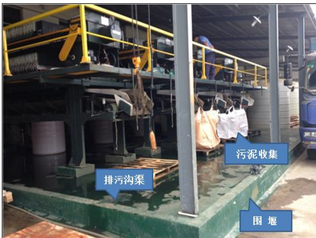
图 3-29 废水站污泥处理区
